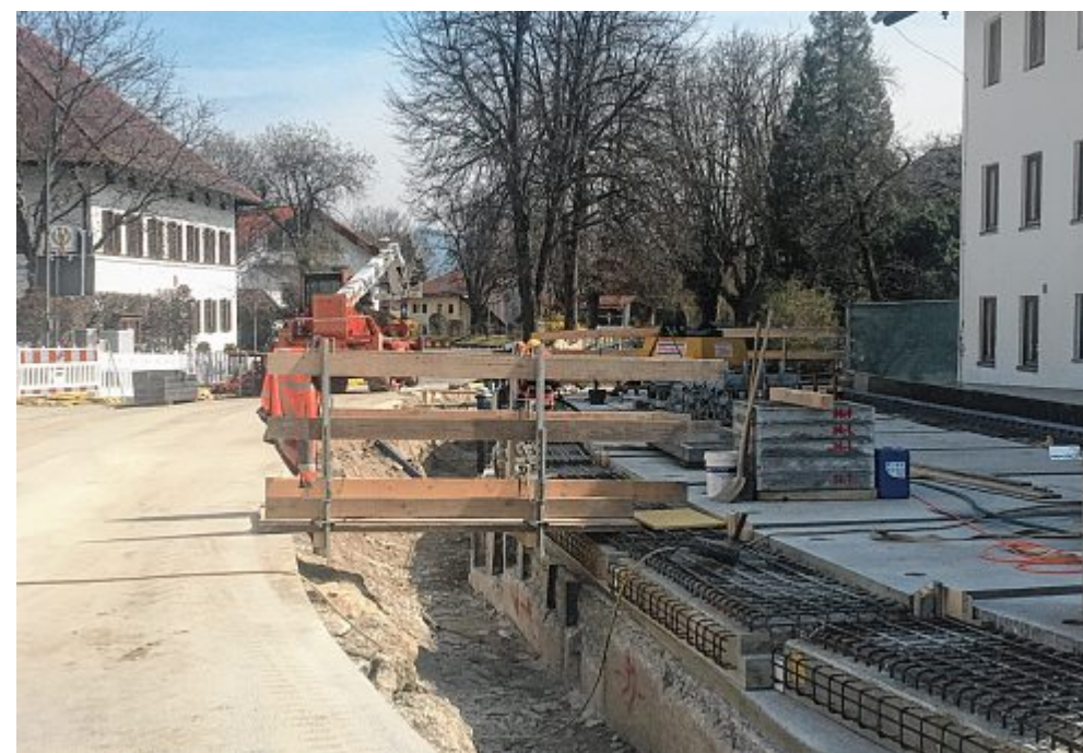
Die ersten Arbeiten laufen bereits für die Maßnahme seit 1. März. Die Bodenplatten sind schon sichtbar, die demnächst verschalt werden.
