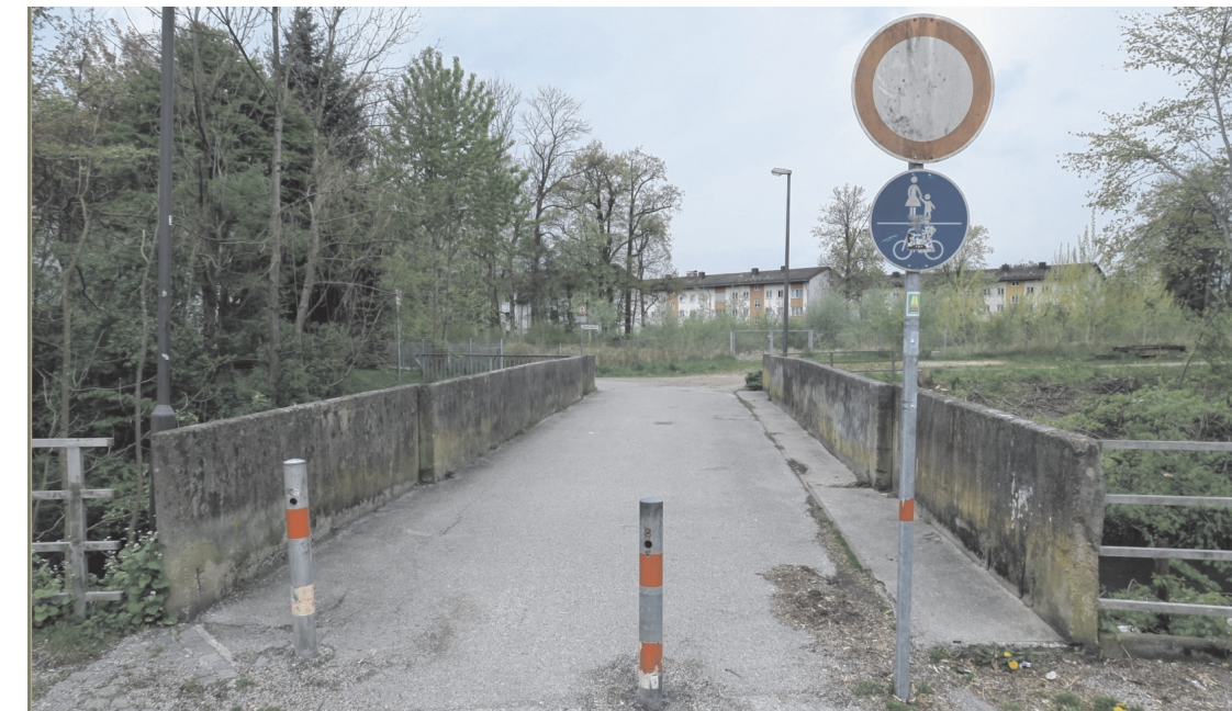
Die für den Kfz-Verkehr nicht mehr ausreichend tragfähige Triftbachbrücke soll durch einen Neubau ersetzt werden.
